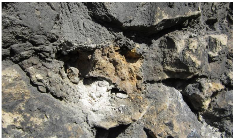
Rys. 11. Erozja kamienia i zaprawy wapiennej
