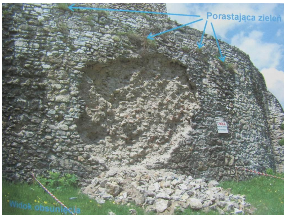
Rys. 21. Odpadnięcie lica muru wschodniego Zamku Będzińskiego w 2005 r. [2.7]
