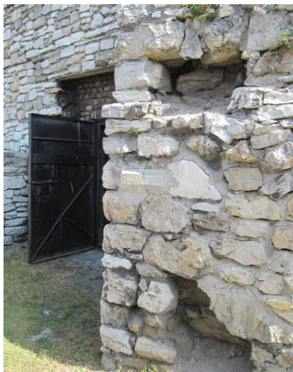
Rys. 10. Przykładowe ubytki muru przypory zamku górnego
