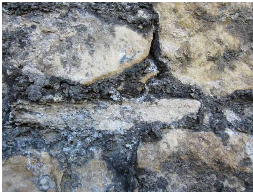
Rys. 13. Przykładowe ubytki muru przypory zamku górnego
