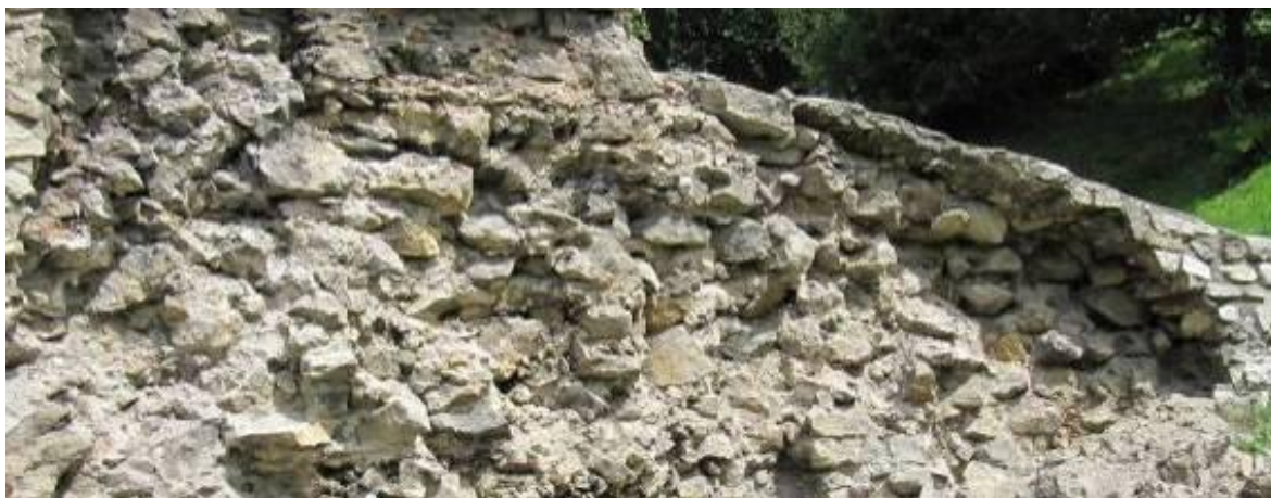
Rys. 7. Struktura muru typu „opus emplectum” ujawniona podczas awarii muru arkadowego w 2010 r.
